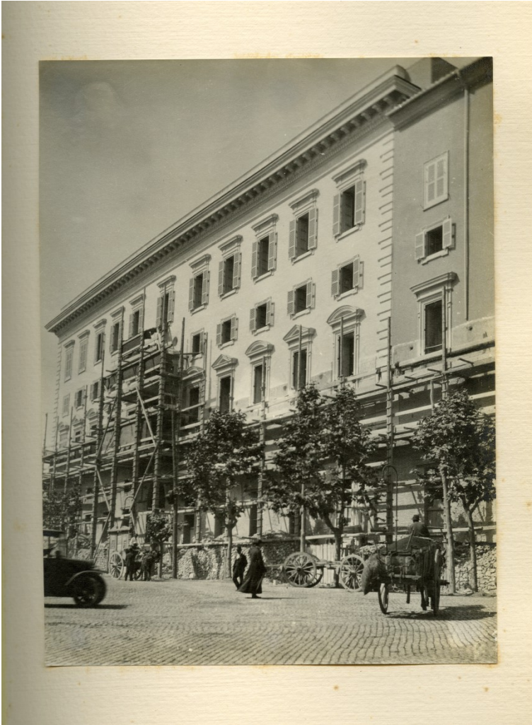
Figura 5 - S. Congregazione del S. Offizio. Ricostruzione del Palazzo. Stato dei lavori al 30 giugno 1924 (ACDF, Privilegia S.O. 1925 n. 16)
